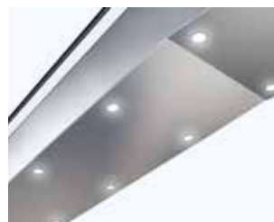
Oświetlenie spodu chodnika
