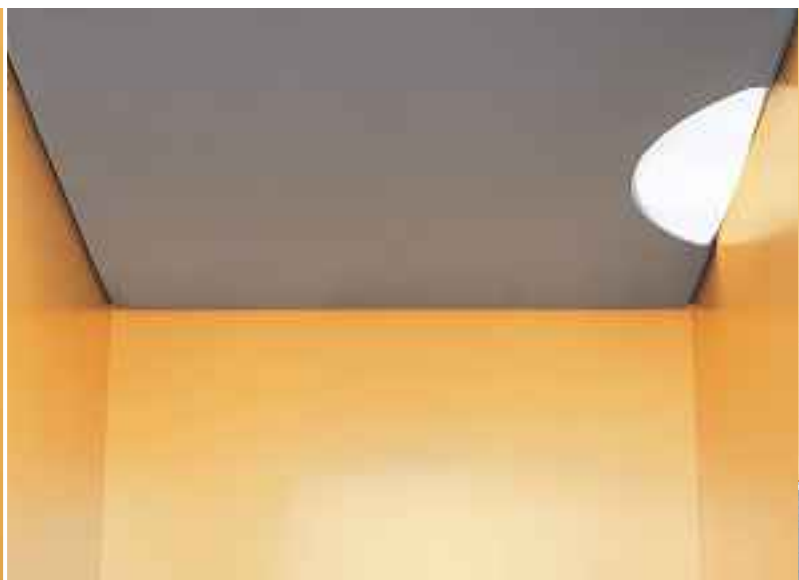
Sufitowe oświetlenie kabiny
